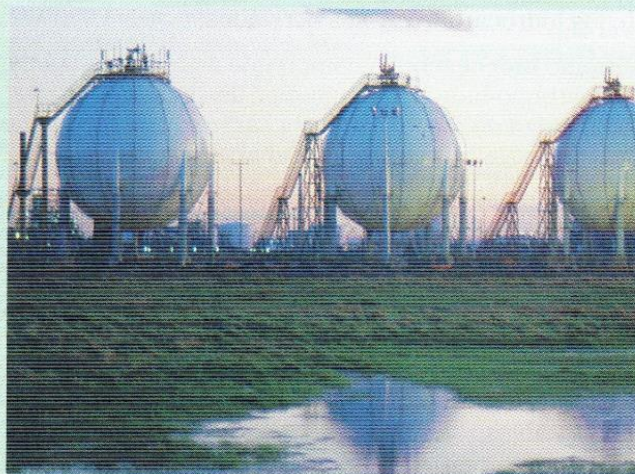
Tanques de almacenamiento de gas natural.
